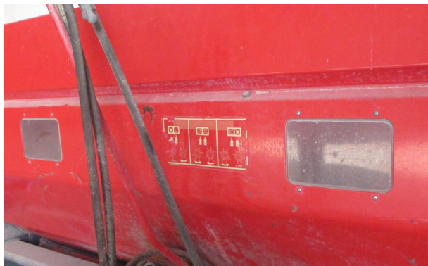
Figura 15. Ventana de inspección.
