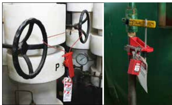
Figura 9. Bloqueo de válvulas (Brady) con LOTO.
