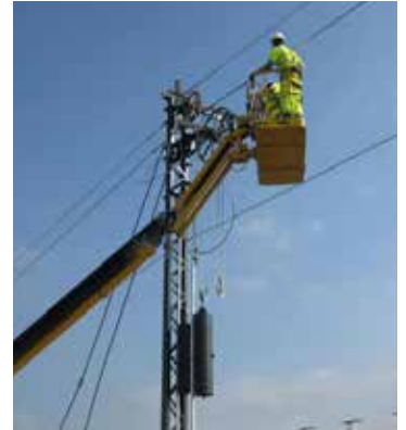
Figura 7. Montaje de un equipo de compensación.
