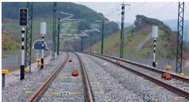
Figura 3. Instalaciones de señalización y de comunicaciones ferroviarias.
