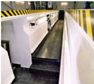
Figura 9. Foso iluminado correctamente
