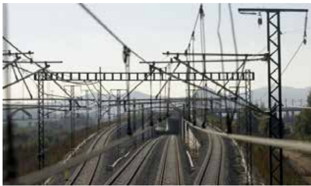
Figura 2. Línea aérea de contacto en vía AVE.
