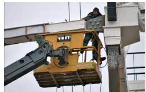
Figura 19. Operario subido sobre las barandillas.
