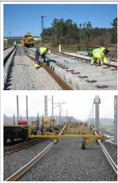
Figura 3. Descarga del carril.
