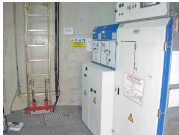
Figura 3. Celdas de alta tensión en la base.
