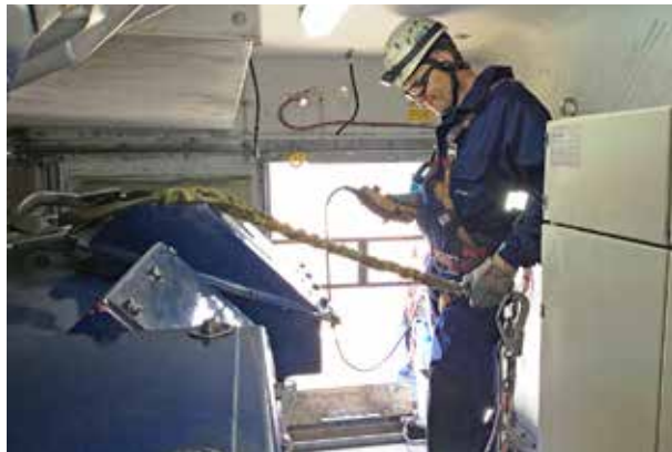
Figura 1. Puerta trasera en la nacelle con polipasto.
